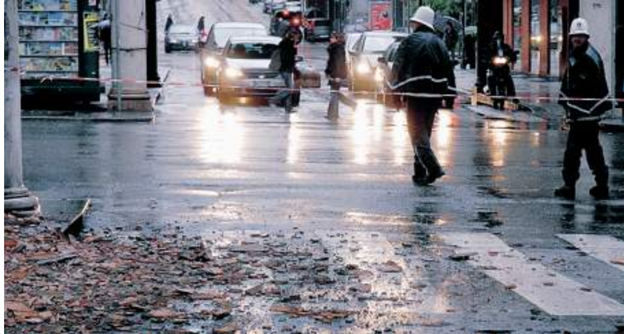
I vigili transennano via Ceccardi invasa dai calcinacci dopo il crollo del cornicione
